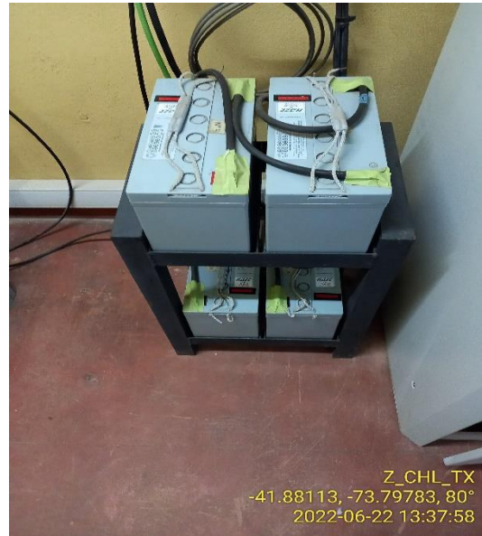
Ilustración 6. Banco de baterías 48Vcc.
