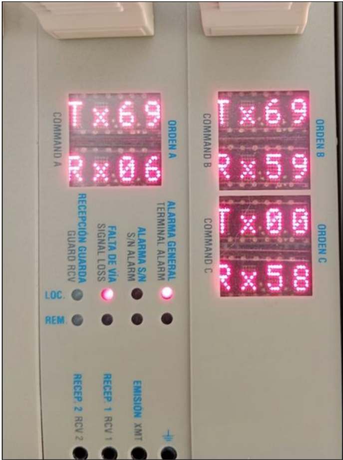
Teleprotección extremo S/E Mampil.
