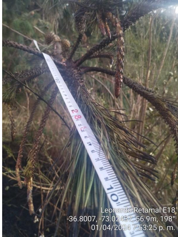
Fotografía N° 3: Resto del árbol (27,3 metros de altura) fuera de faja de seguridad cortado por terceros que cae sobre la línea LT Alonso de Ribera-Chiguayante entre las estructuras 12 y 13.
