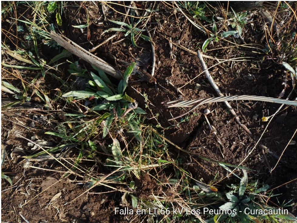
Fotografía N°3. Se muestra corte intensional de los cables robados.
