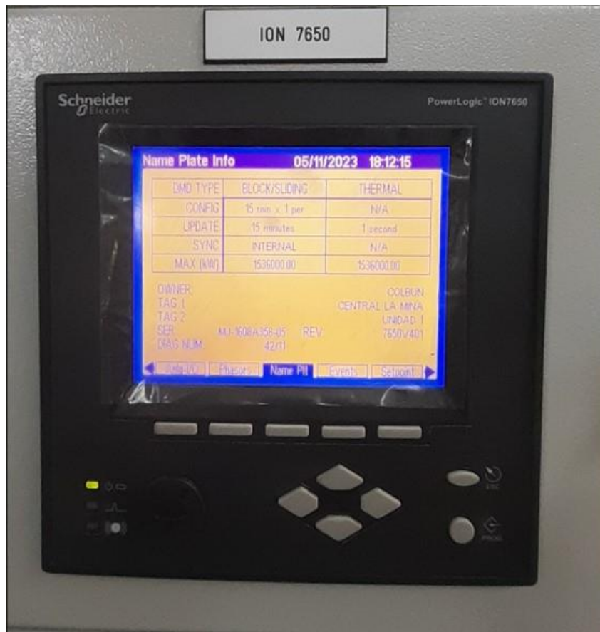
Figura 9-5 – Equipo medidor ION 7550 – Potencia bruta U1
