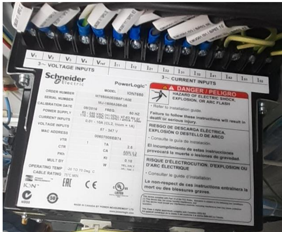
Figura 9-6 - Equipo medidor ION 7550 – Potencia bruta U1
