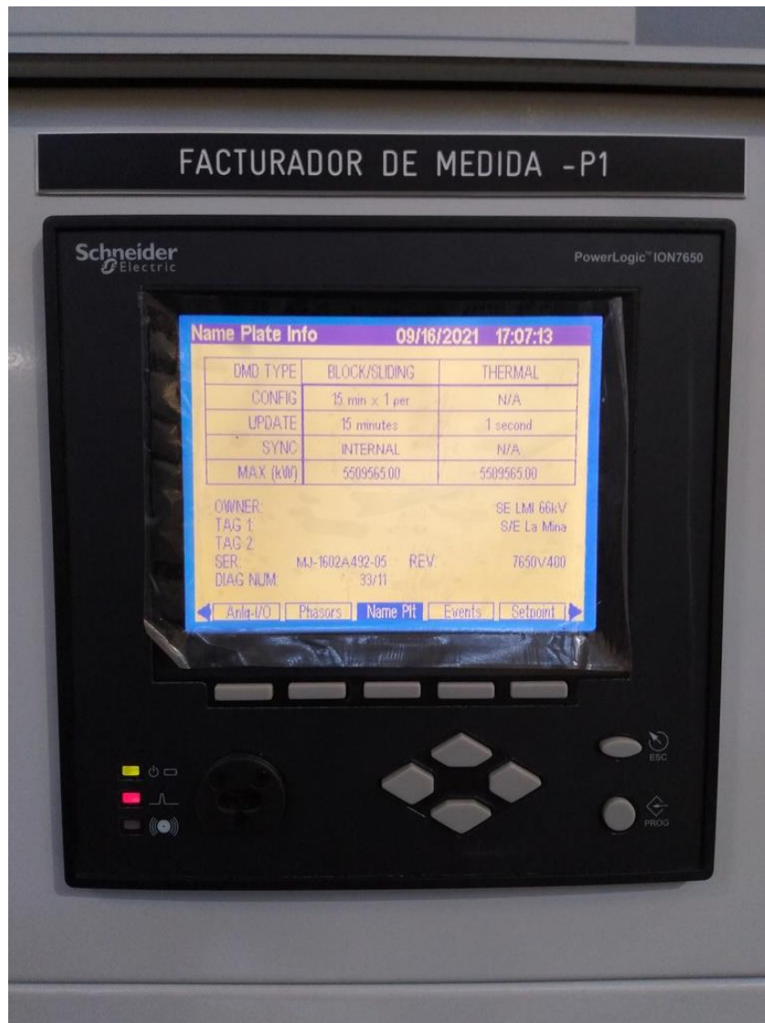
Figura 9-11 – Equipo medidor ION 7650 – Potencia neta
