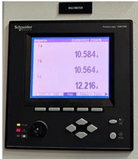
Figura 9.13 – Equipo medidor ION 7550 SSAA
