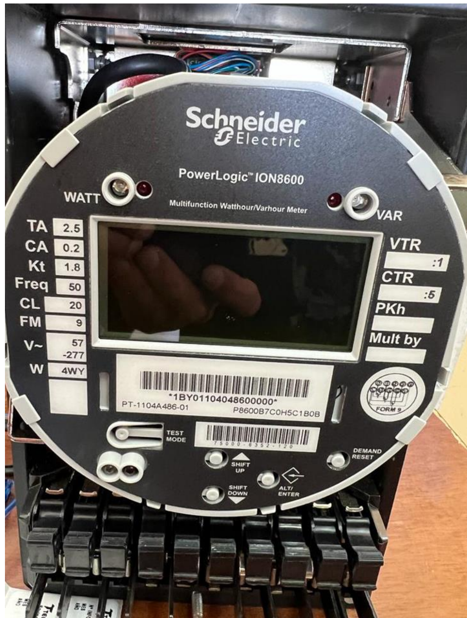
Figura 9.11 – Equipo medidor ION 8600 potencia neta
