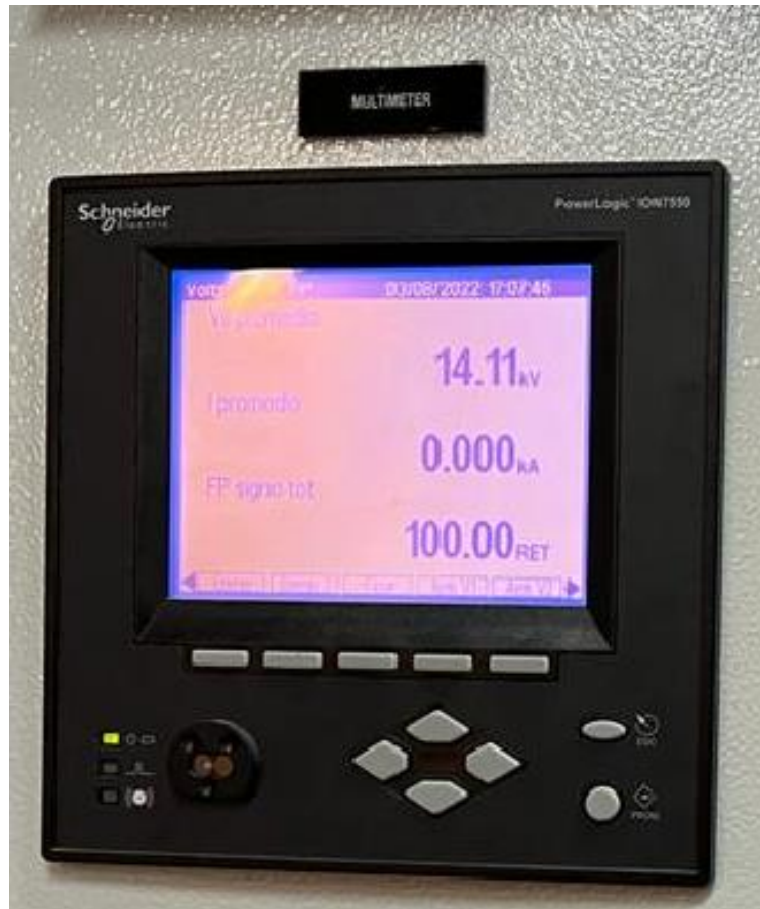
Figura 9.8 – Equipo medidor ION 7550 potencia bruta
