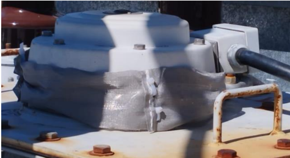
Figura 3 Instalación de protección para evitar ingreso de aves a actuador
