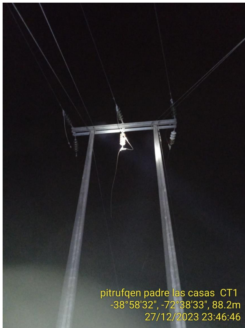
Imagen N°1: Punto de falla entre estructuras 225 y 226
