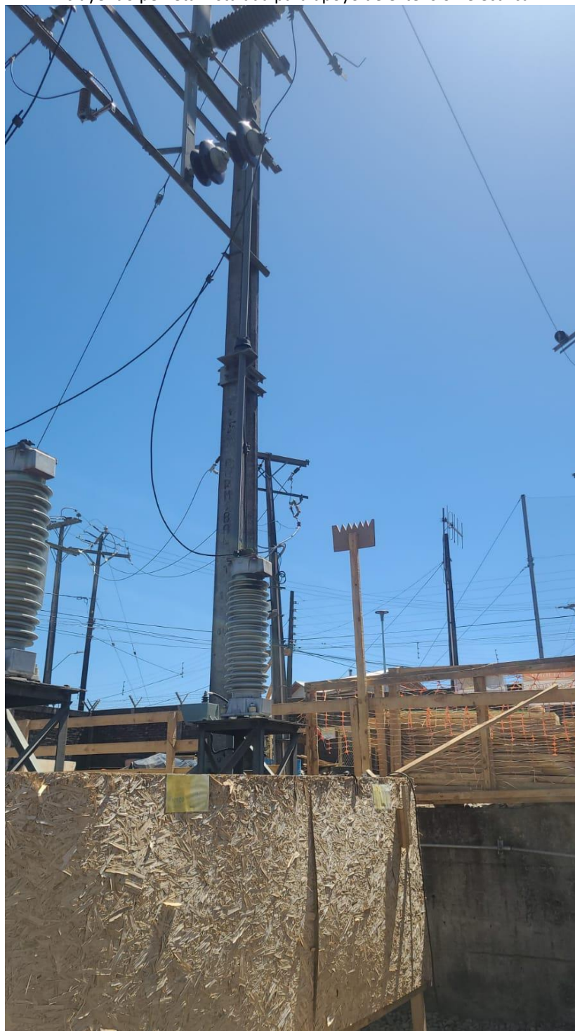
Figura 2: Vista panorámica de pararrayos del TR2 66/13,8 kV, en donde ocurre el acortamiento de distancia, incluyendo peineta instalada para apoyo de extensión eléctrica.
