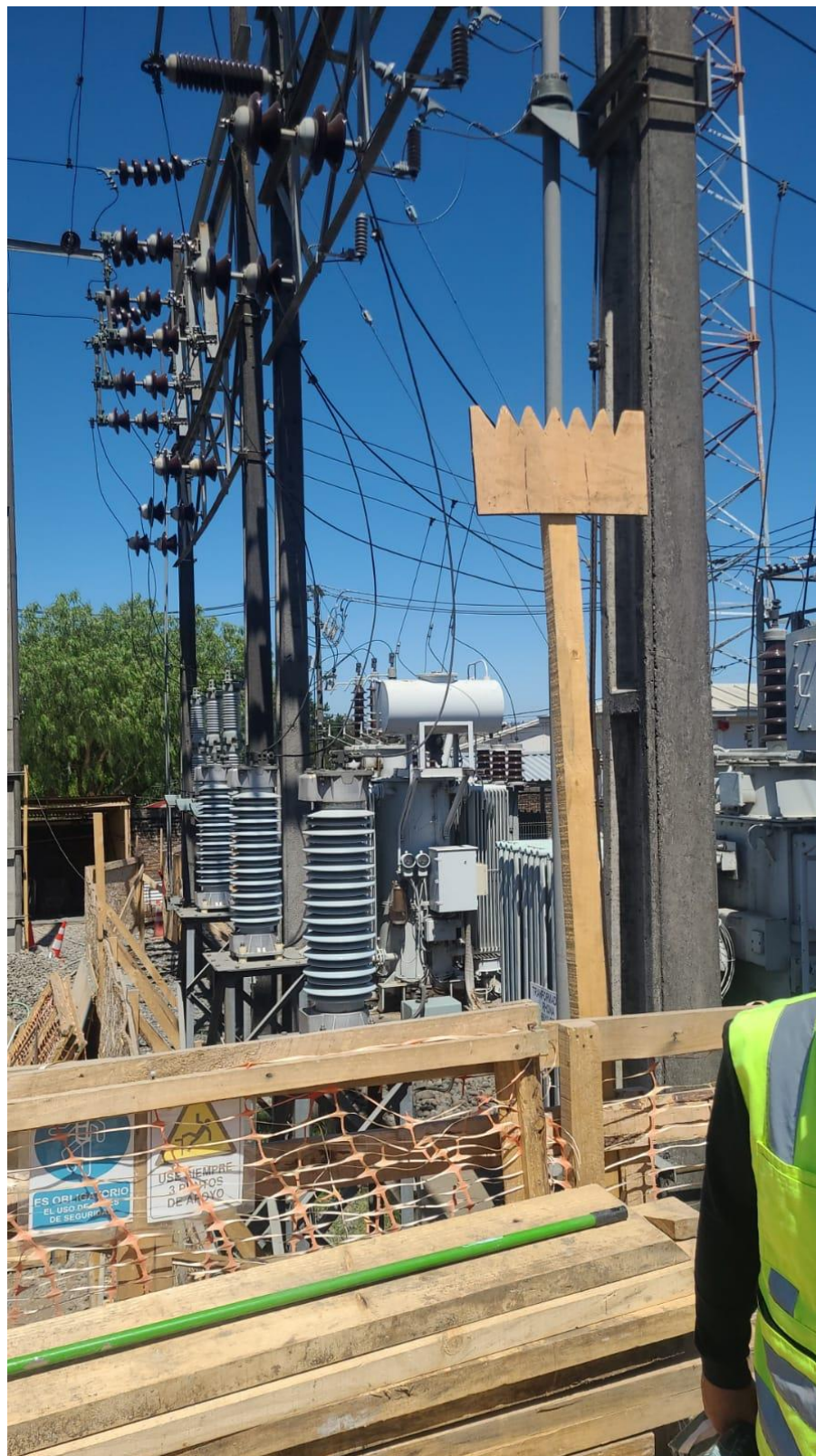
Figura 3: Vista frontal de pararrayos del TR2 66/13,8 kV, en donde ocurre el acortamiento de distancia, incluyendo peineta instalada para apoyo de extensión eléctrica.
