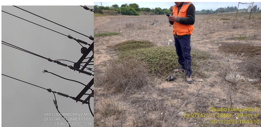
Ave electrocutada y puente abierto en estructura común de alimentadores Panamericana y Peñuelas
