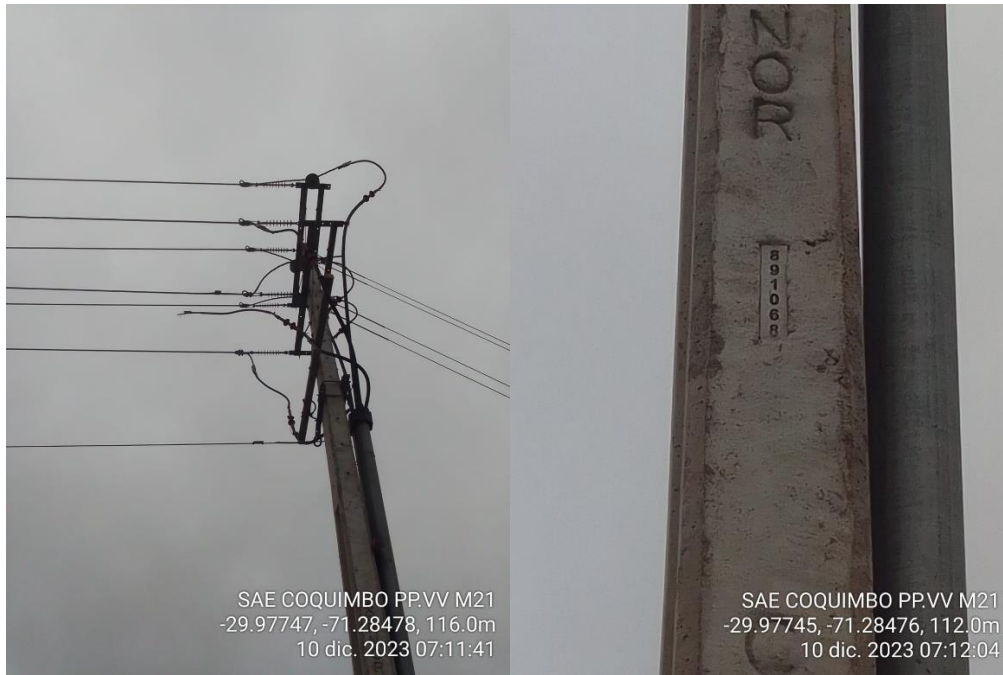
Lugar falla en postación común alimentadores Panamericana y Peñuelas en el exterior de SE Pan de Azúcar
