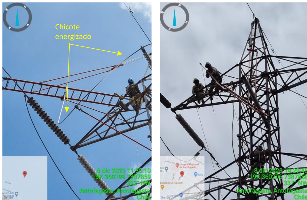
Figura 2: Condición previa a evento con chicote aislado en escala dieléctrica de E160 posterior al evento con la escala desplazada hacia la estructura.
