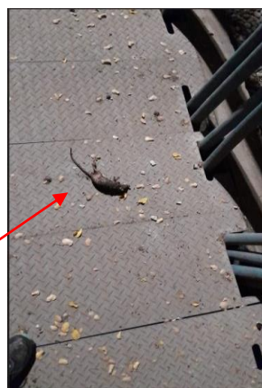
Roedor que provocó la falla
