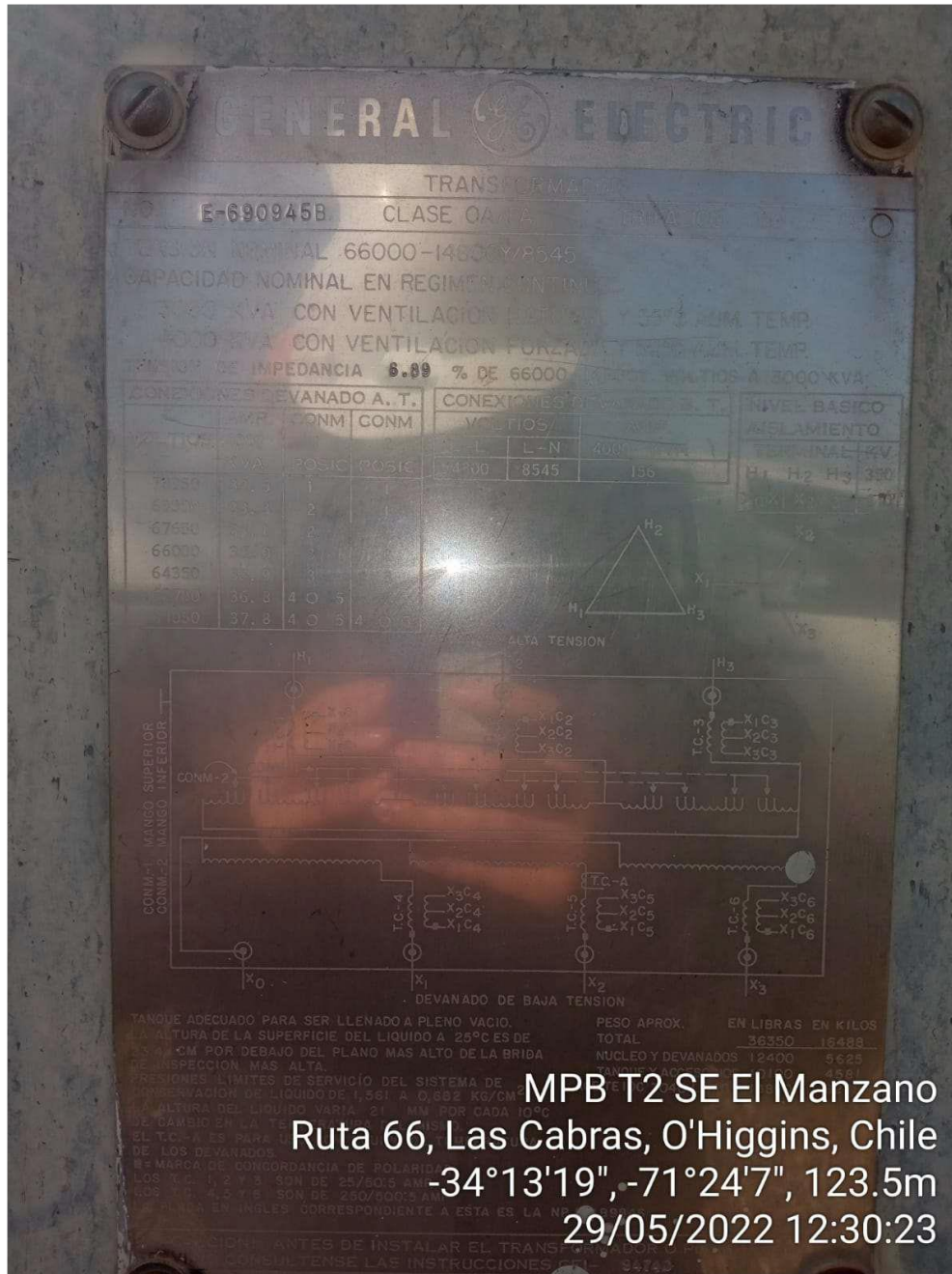
Ilustración 2.- Dato de placa Transformador N°2
