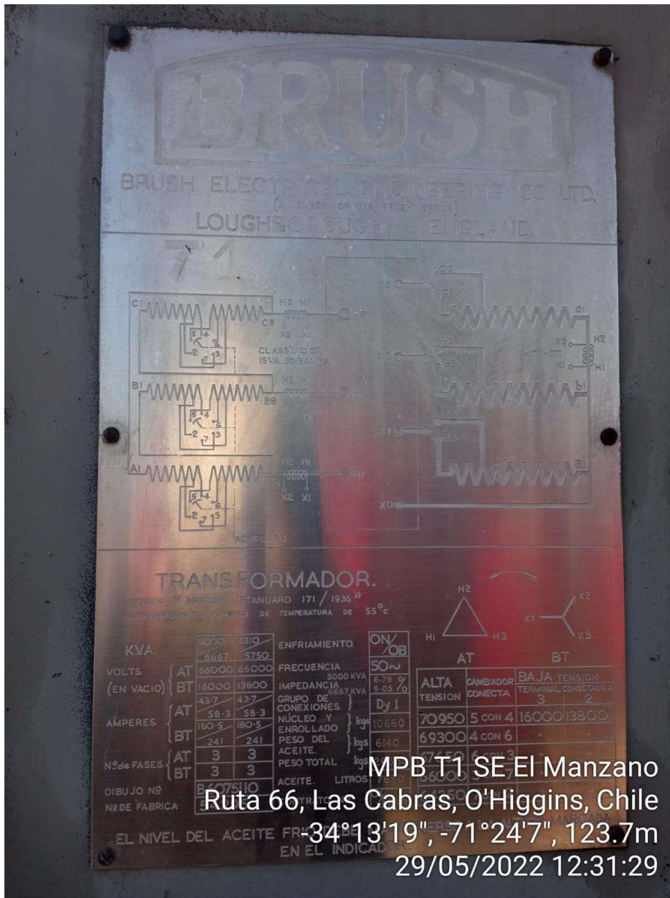
Ilustración 1.- Dato de placa Transformador N°1
