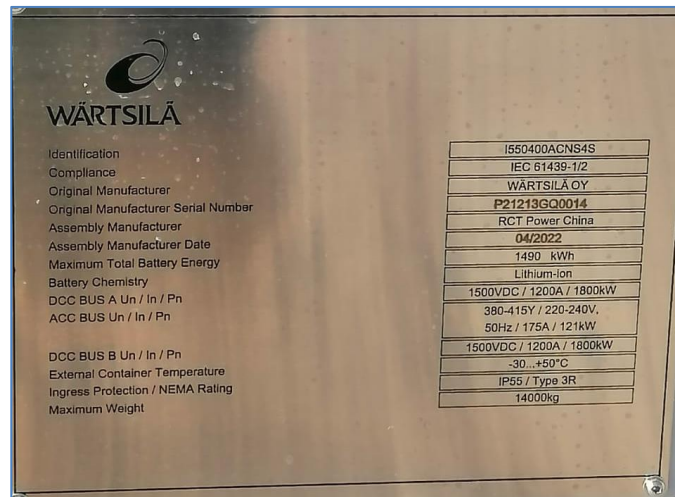
Figura 4.16: Foto de placa módulos de baterías BESS DAS.
