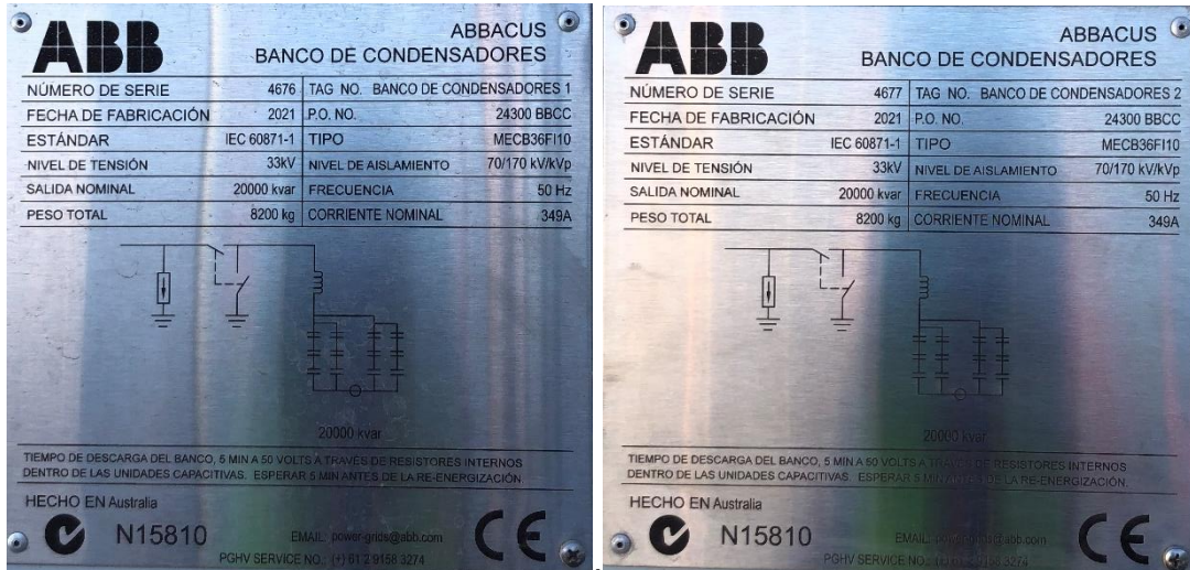
Figura 6.7: Fotos de placa banco de condensadores.
