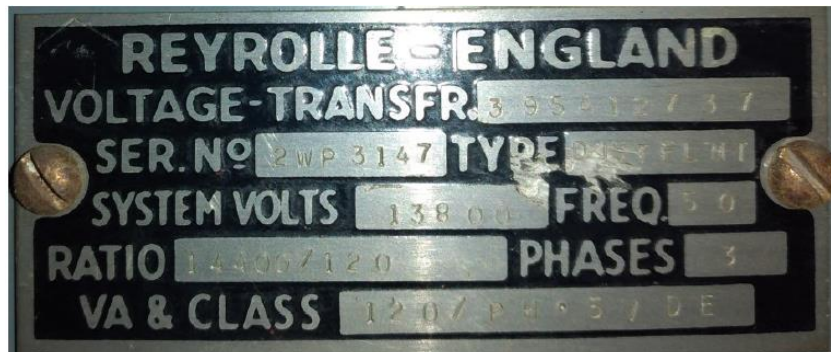
Figura 9.21 - Datos de placa PT - Barra N°2 (Alimentador 52C22)
