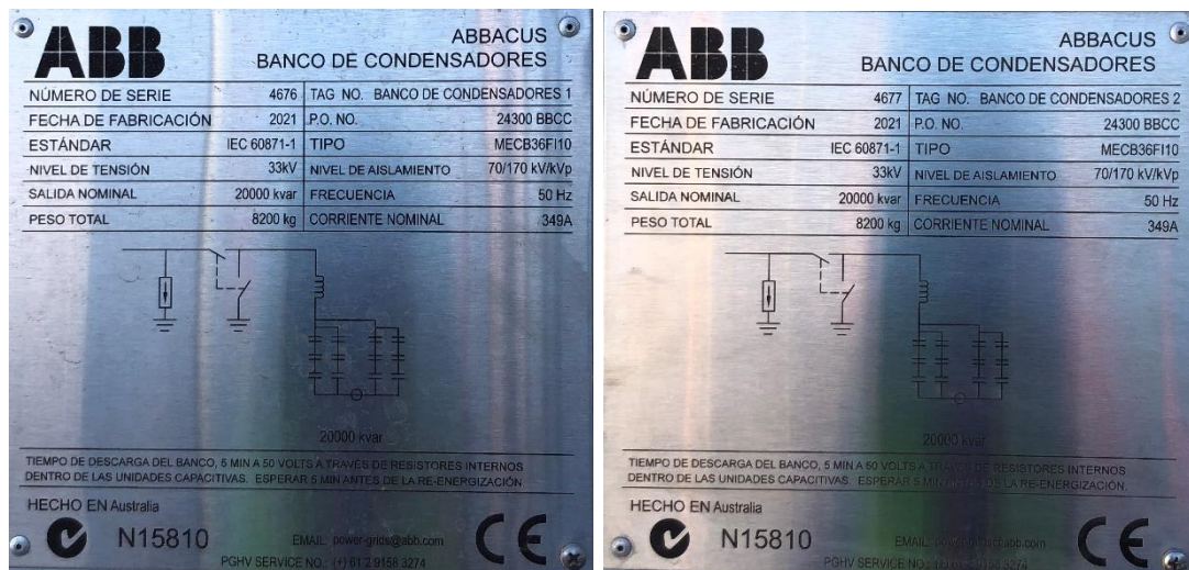
Figura 3.13: Fotos de placa banco de condensadores.
