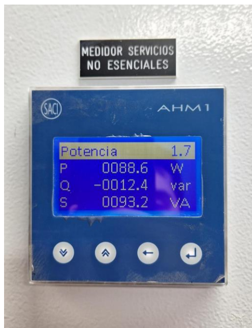
Figura 6.2 – Medidor servicios no esenciales
