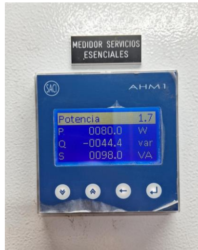
Figura 6.1 – Medidor Servicios Esenciales
