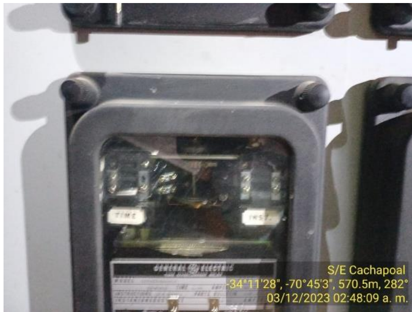
Imagen 3.- Protección de sobre corriente fase C.
