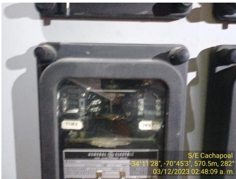
Imagen 4.- Protección de sobre corriente fase C.
