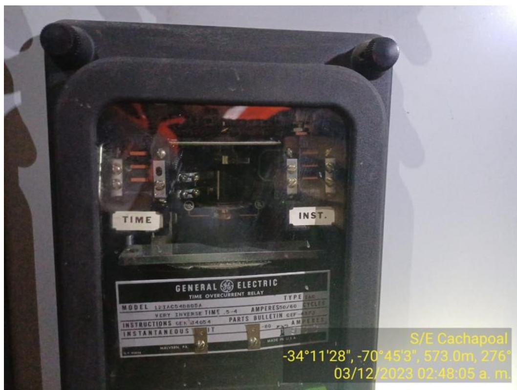
Registro fotográfico del relé electromecánico GE 12IAC54B805A del paño B3 de S/E Cachapoal
