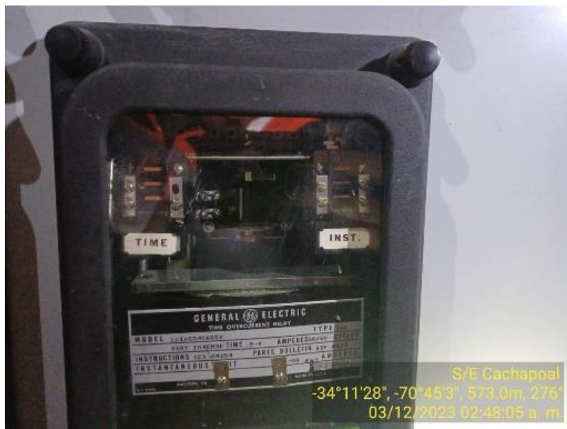
Imagen 2.- Protección de sobre corriente fase B.
