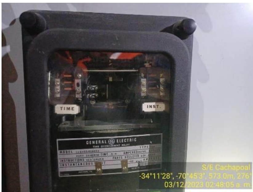
Imagen 3.- Protección de sobre corriente fase B.
