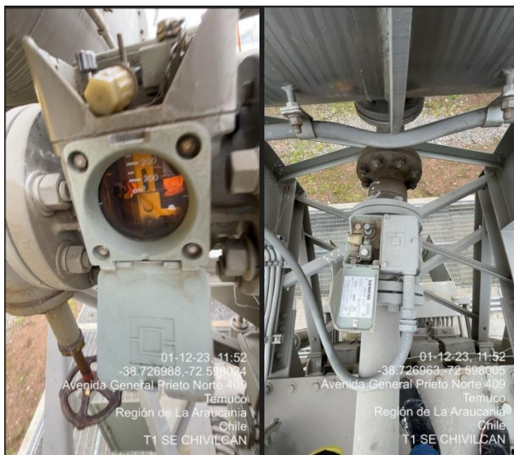
Figura 3; Imagen referencial de la operación del relé de flujo del CDBC del Transformador T3
