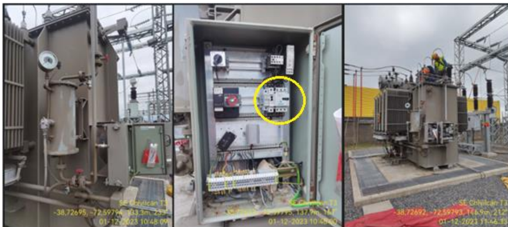
Figura 2; Bomba de filtrado de aceite del CDBC, guardamotor de bomba de filtrado en gabinete de control y faena de normalización del relé de flujo CDBC del T3.
