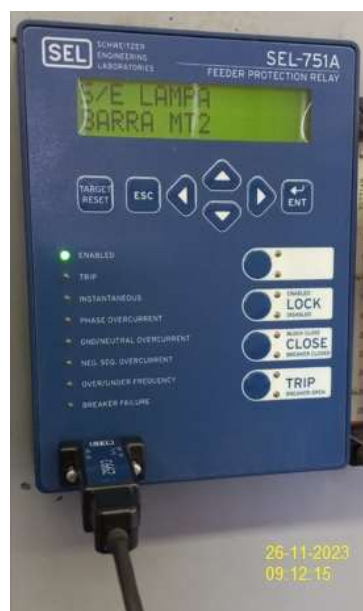
Protección del interruptor de MT del Transformador N°2, conectada al puerto de comunicación.
