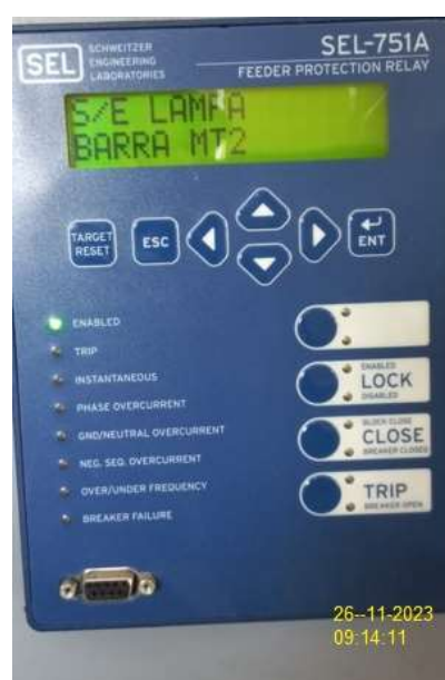
Protección del interruptor de MT del Transformador N°2.
