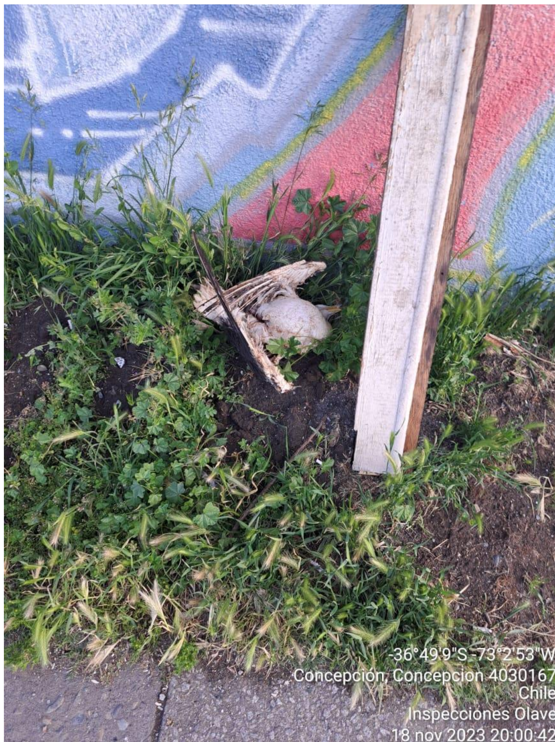
Fotografía Nº 1: Ave (gaviota) muerta encontrada en punto de falla.
