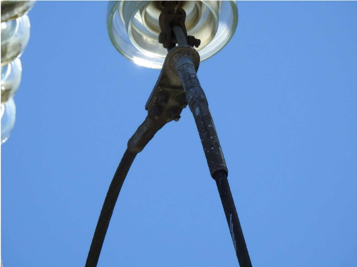
Fotografía N°3: Signo de descarga eléctrica fase 1.
