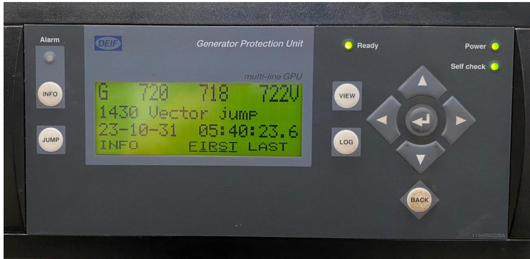
Figura 2: Registro operación controlador DEIF, protección “Vector jump”.
