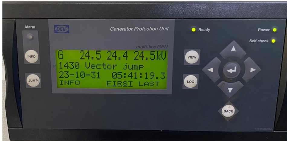
Figura 2: Registro operación controlador DEIF.
