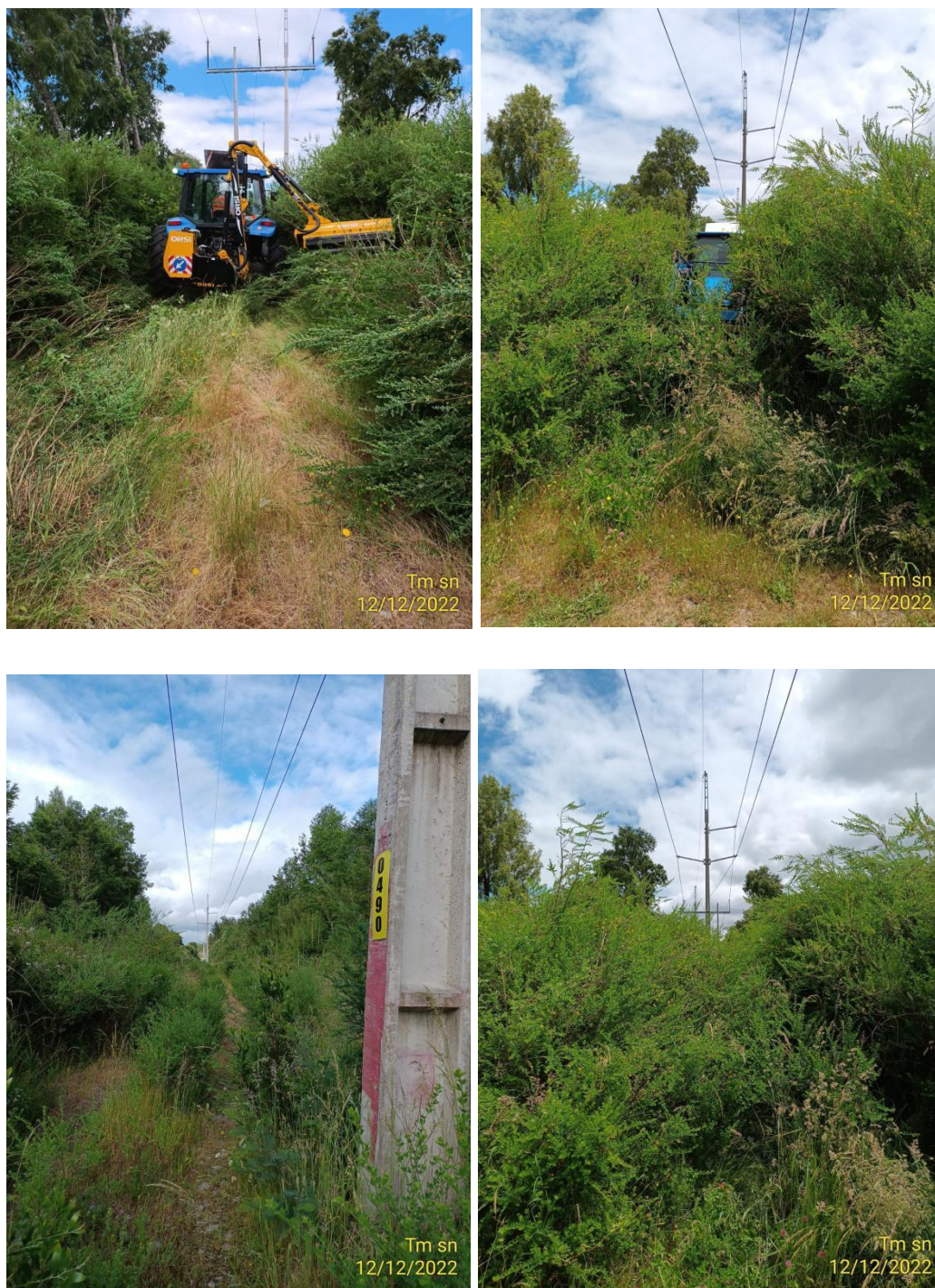
Figura 5: Trabajos en sector los Juanes entre ET 494 Y 488. Se observa matorral muy denso, con camino en faja LT totalmente cerrado, condición de trabajo muy pesada.
