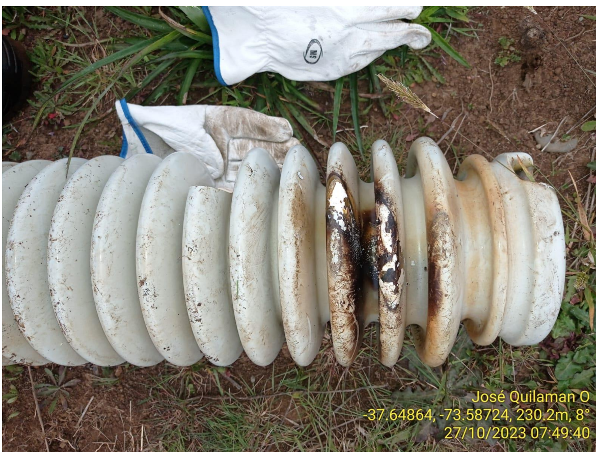
Fotografía N° 1: Line post estructura N° 583 con señales de descarga.
