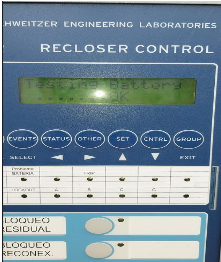
Imagen tes batería al relé SEL 351R de Paño C3 SE LEBU
