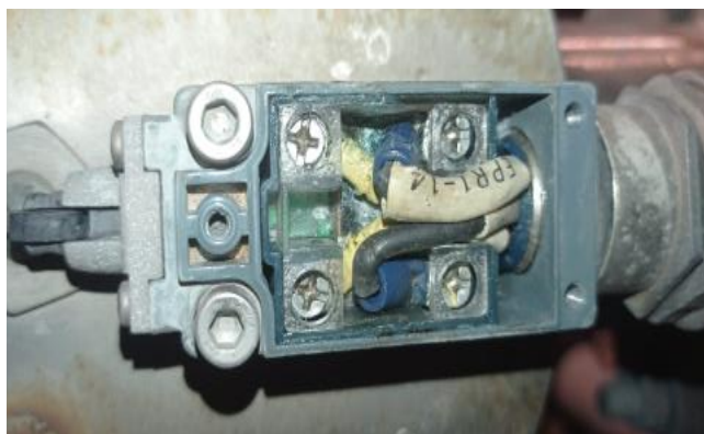
Imagen N°3: Relé de Sobrepresión del Transformador 1 de 110/23 kV de S/E Castilla con humedad.
