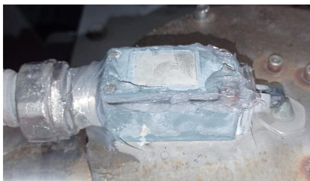
Imagen N°4: Relé de Sobrepresión del Transformador 1 de 110/23 kV de S/E Castilla sellado.
