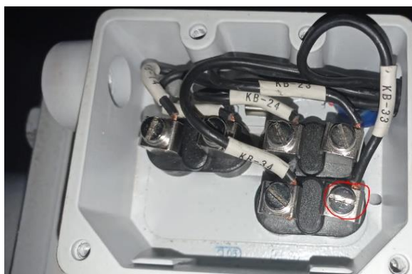
Imagen N°2: Relé Buchholz del Transformador 1 de 110/23 kV de S/E Castilla.
