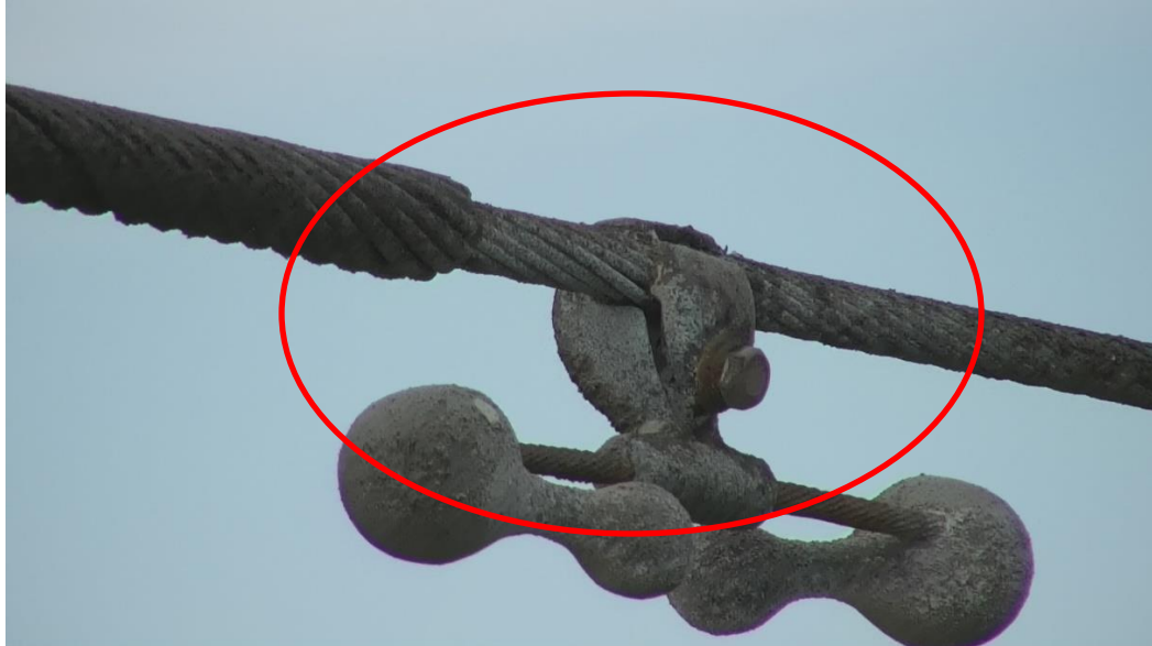
Fotografía tomada desde estructura de 129, circuito Antofagasta alto Norte 110 KV, fase superior hebra cortada a la altura del amortiguador de salida.
