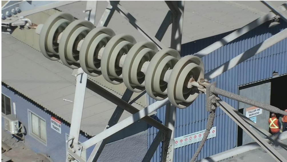
Fotografía estructura de anclaje 135, muestra cadenas de aisladore de vidrio, aparentemente sucias.
