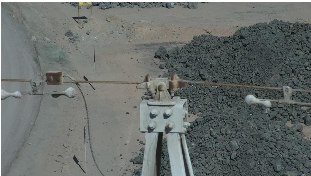
Fotografia muestra estructura de suspension numero 133, cable guardia, con oxidacion leve en conjunto.
