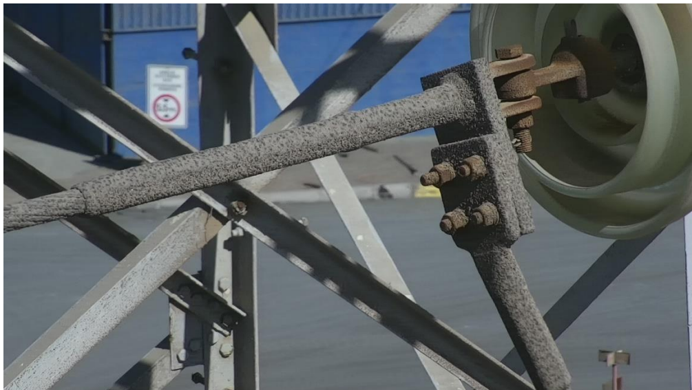
Fotografía muestra estructura de anclaje numero 135, grampa de compresion y puente electrico, observaciones alta corrocion en conductor y grampa de compresion, pernos con oxidacion leve, sin perdida de material.
