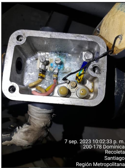
Imagen 1: Caja con humedad
