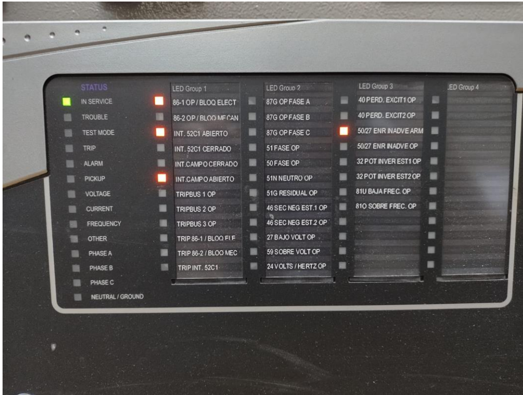
Fotografía relé GE-60 Unidad 1
