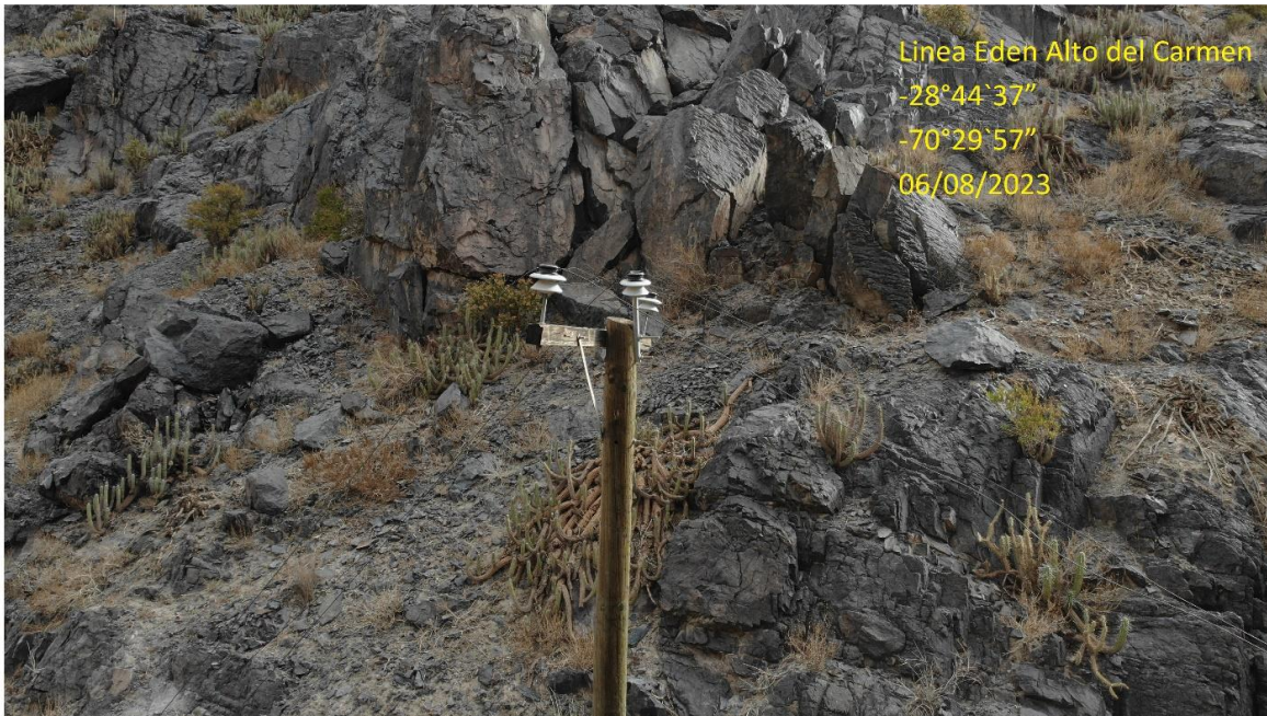
Fotografía N° 1: Estructura madera M.T. ubicada en el cerro, cruceta de madera torcida.
