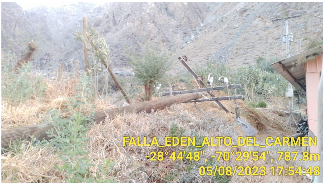
Fotografía N° 9: Estructura madera M.T. circuito alimenta S/E 4816 – 30kVA (particular).
