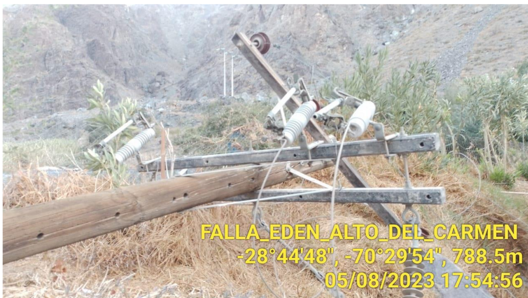
Fotografía N° 10: Estructura madera M.T. circuito alimenta S/E 4816 – 30kVA (particular).
