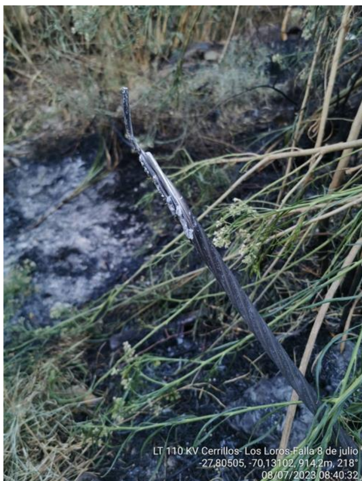
Fotografía N°7_ Evidencia de descarga y conductor cortado de fase C, lado estructura N°154
