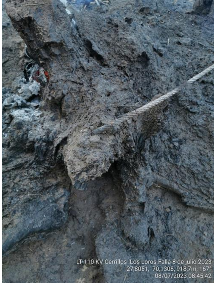
Fotografía N°10_ Corte de conductor fase B
