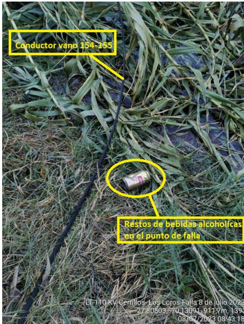
Fotografía N°4_Evidencia de restos de bebidas alcohólicas en vano estructura N°154-155
