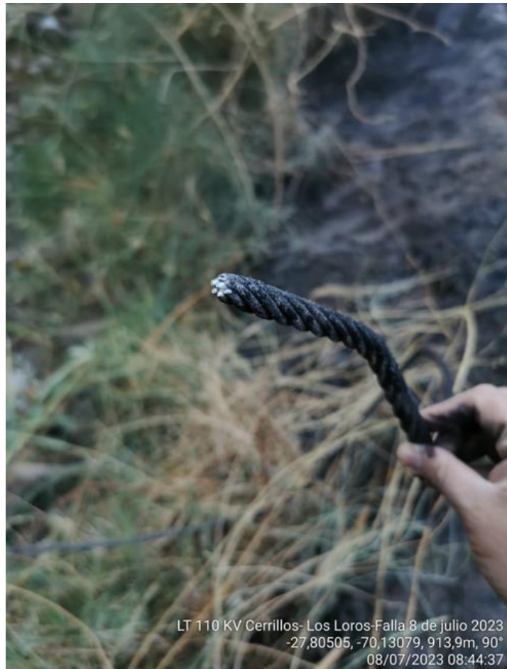
Fotografía N°11_ Corte de conductor fase A
