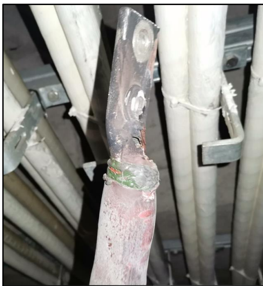
Cable de MT alimentador Honduras Mufa terminal (paleta) con muestra de punto caliente
