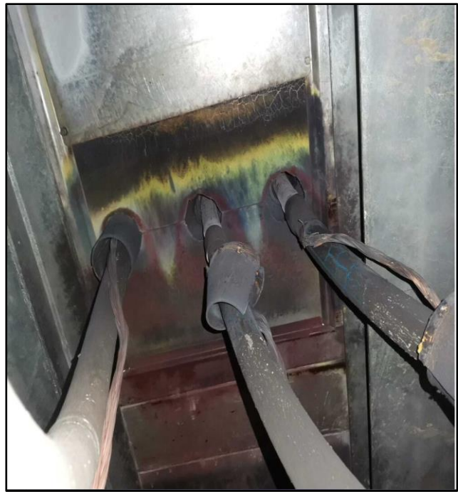
Vista inferior cubículo de la salida de cables de MT siniestrado. Salida de los cables de MT del alimentador Honduras dañados.
