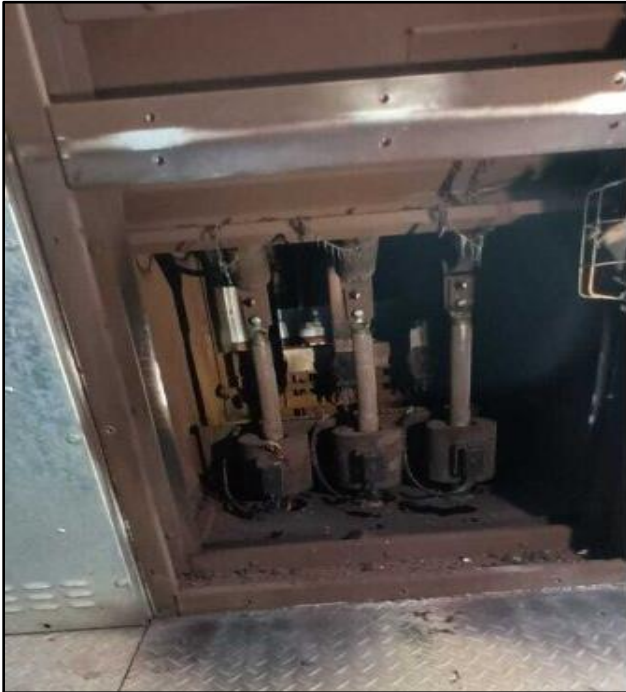
Vista posterior de la Celda del Alimentador Honduras (Barra MT3). Se observa el cubículo de la salida de cables de MT siniestrado: • Cables de Control dañados • Transformadores de corriente dañados
