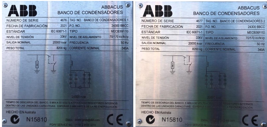
Figura 3.13: Fotos de placa banco de condensadores.
