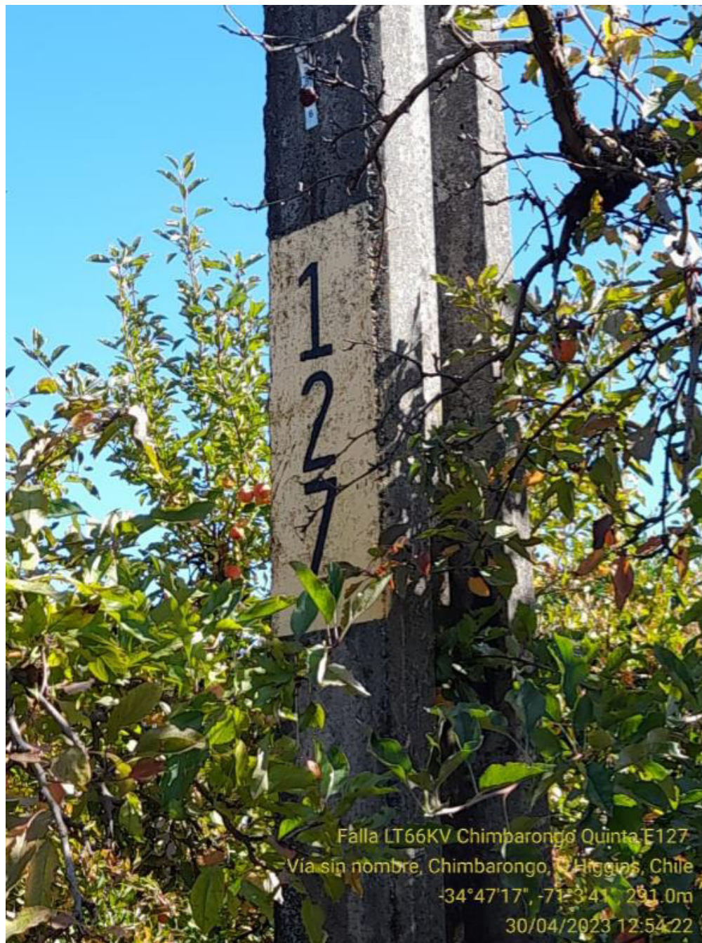
Imagen 3: Ubicación del aislador dañado
