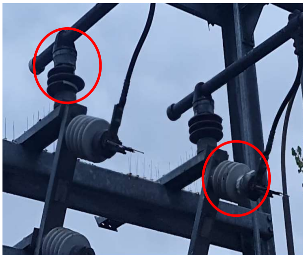
Aislación dañada producto del arco eléctrico
