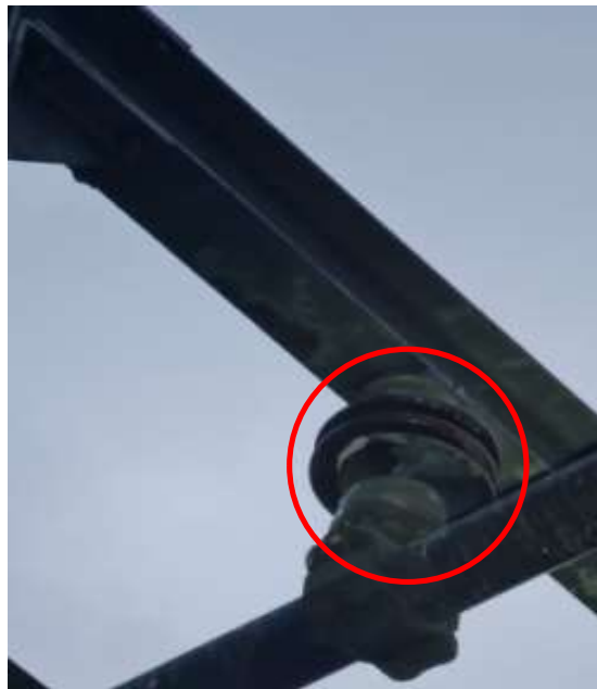
Fotografía 2: Aislador soporte de barra
