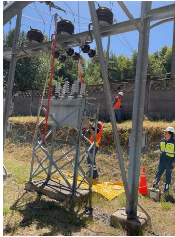
Figura 15 Vista de Reconectador Paño C6
