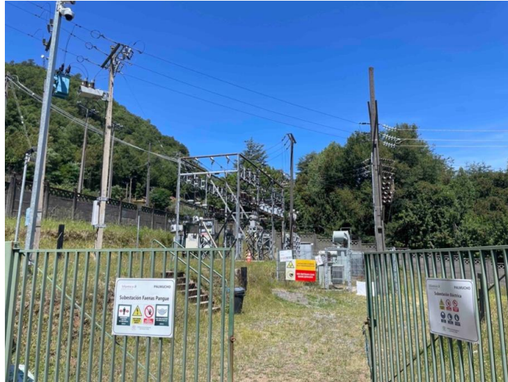
Figura 5 Vista general de la S/E Faenas Pangué
