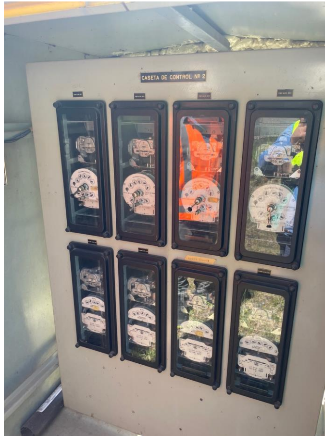
Figura 12 Equipos de medida y facturación de la S/E Faenas Pangué.
