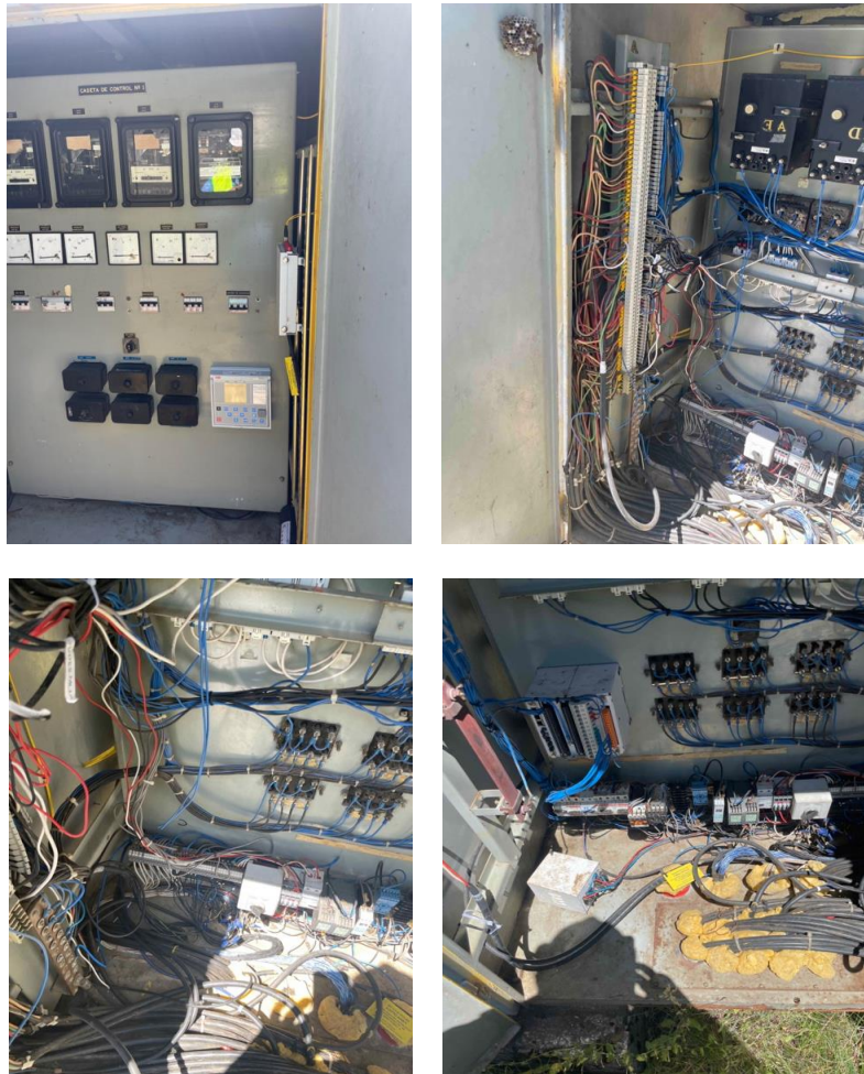
Figura 7 - Gabinete de control y protecciones de CT11
