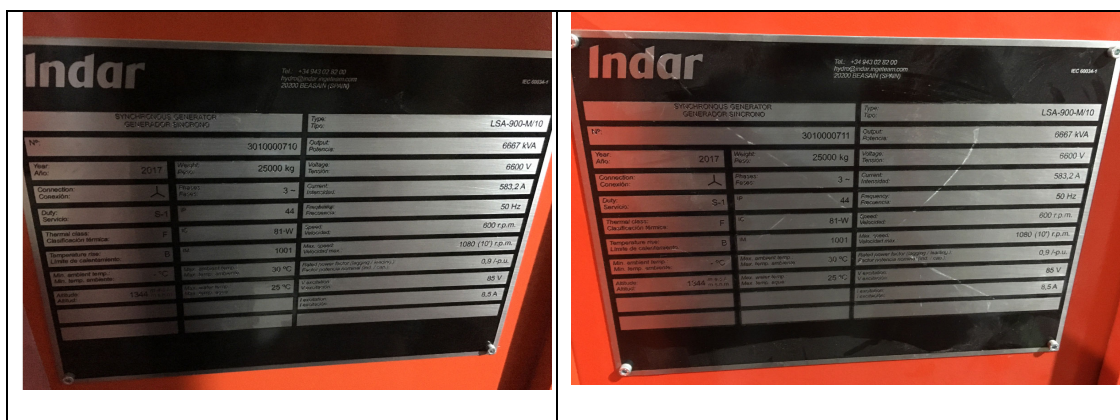
Fotografía 2 Placa Características de Generadores Indar
