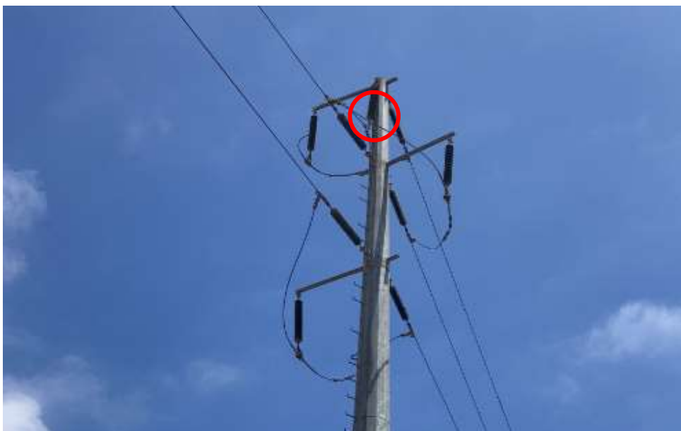
Foto 3: Estructura N° 30 L. 110 kV Pan de azúcar – Las compañías: Estructura en la cual se corta conductor fase superior.
