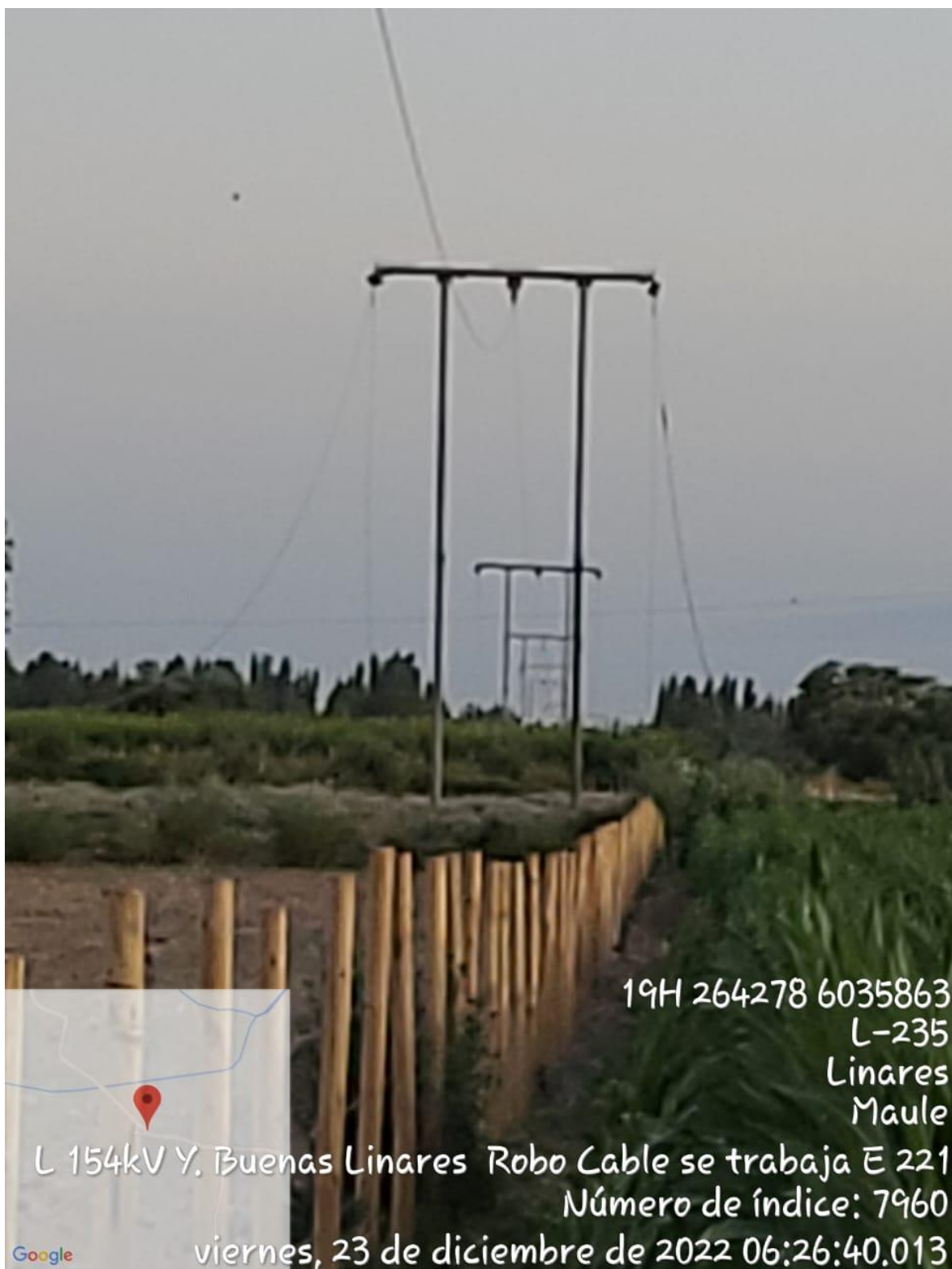
Figura 3: Robo de conductores registrado en la estructura N°221 del tramo de línea Yervas Buenas – Linares 154 kV.
