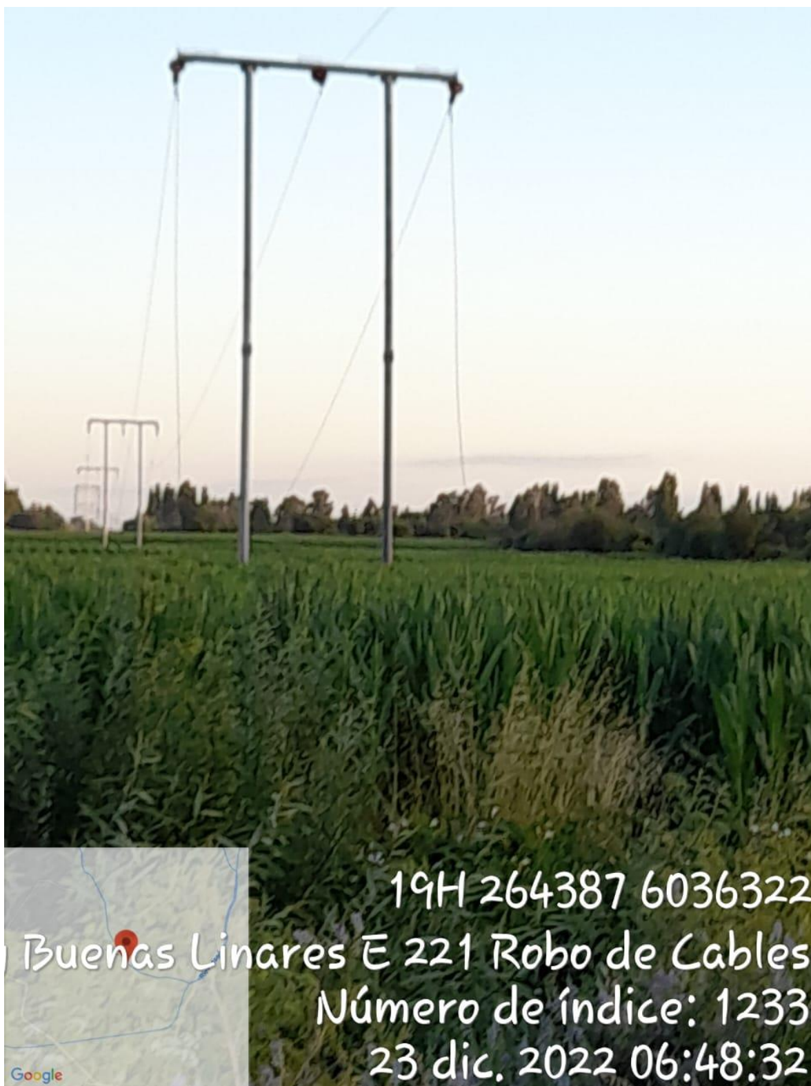
Figura 4: Robo de conductores registrado en la estructura N°221 del tramo de línea Yervas Buenas – Linares 154 kV.
