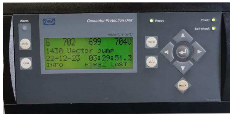
Figura 3: Registro operación controlador DEIF, protección Vector Jump.
