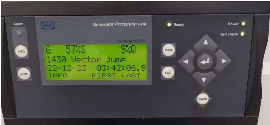
Figura 1: Registro operación controlador DEIF.
