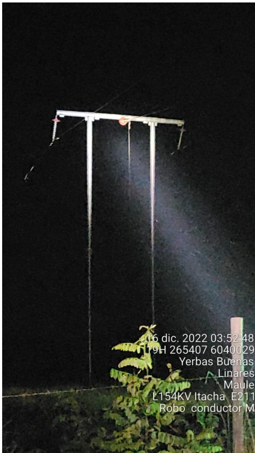
Figura 3: Robo de conductor registrado en la estructura N°211 del tramo de línea Yervas Buenas – Linares 154 kV.
