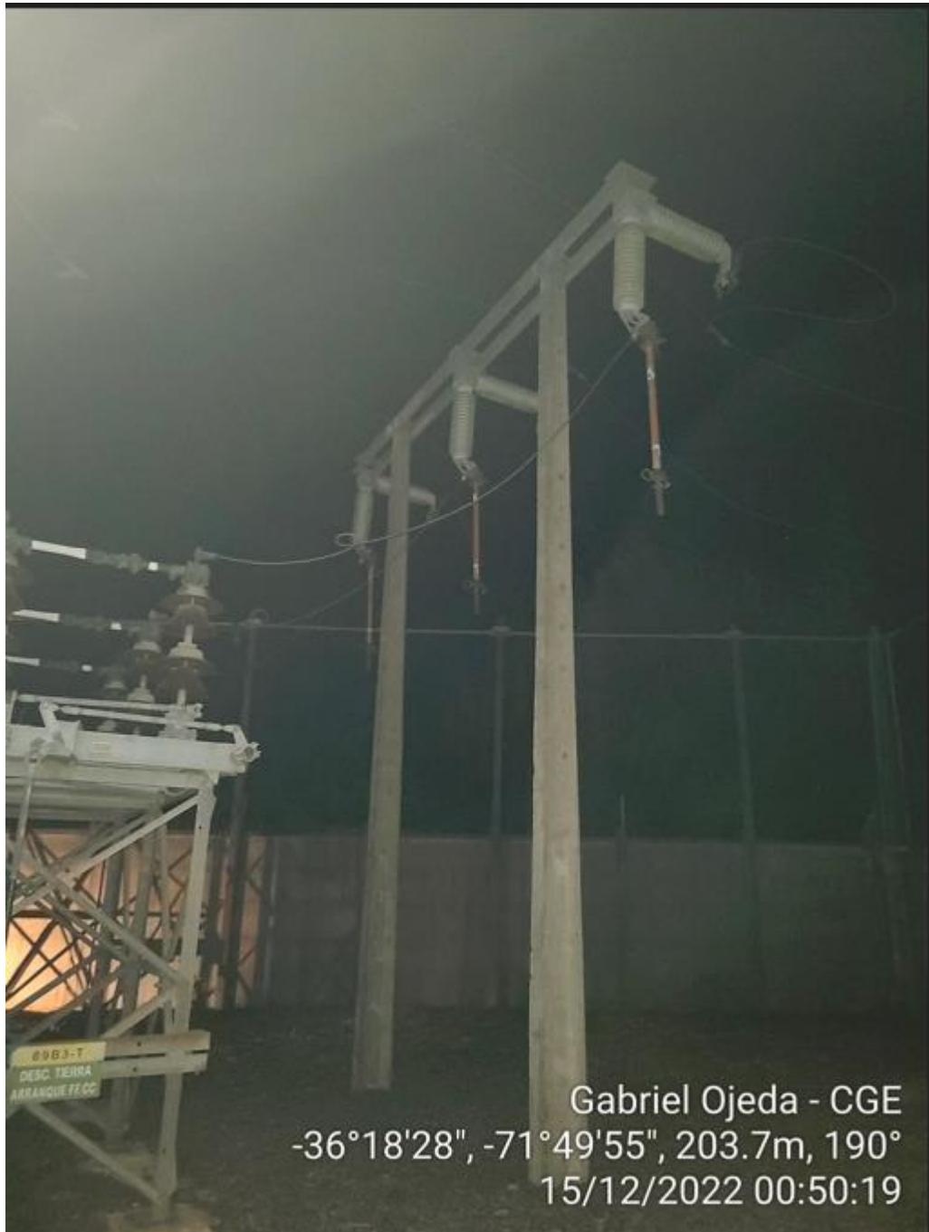
Fotografía: Fusibles 89B3 operados en Tap Ñiquén.
