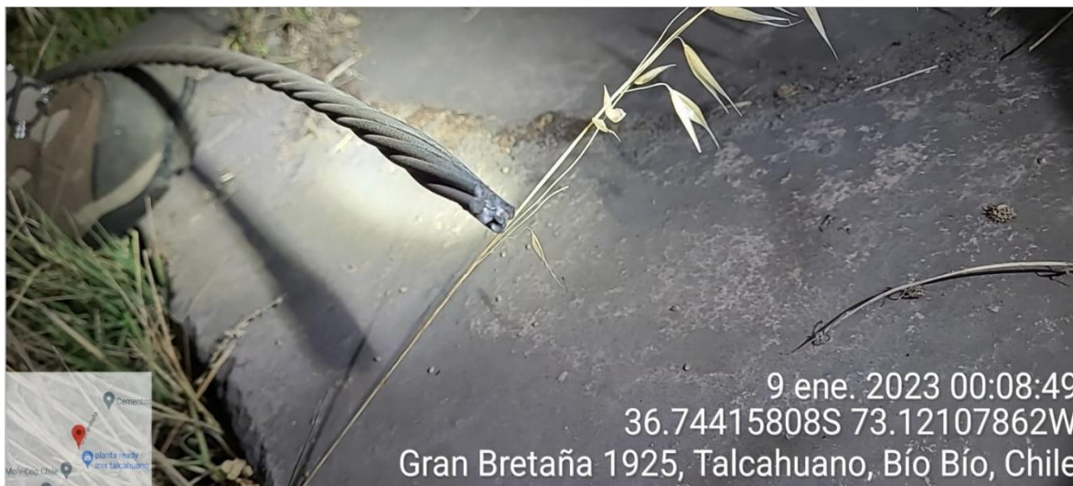
Figura 5: Conductor cortado encontrado en el suelo.
