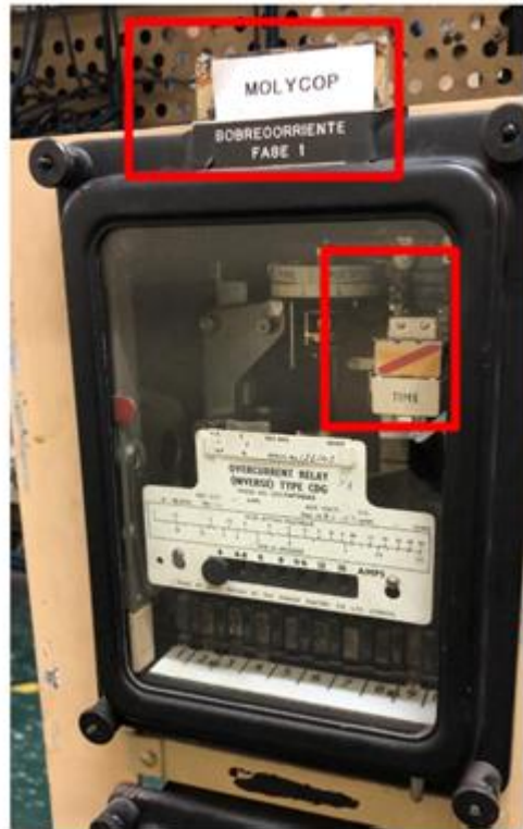
Figura 2: Protección Alstom-CDG 11-51 de sobrecorriente de fase temporizada (51), operada en paño C2 de S/E San Vicente (se señala bandera de operación).
