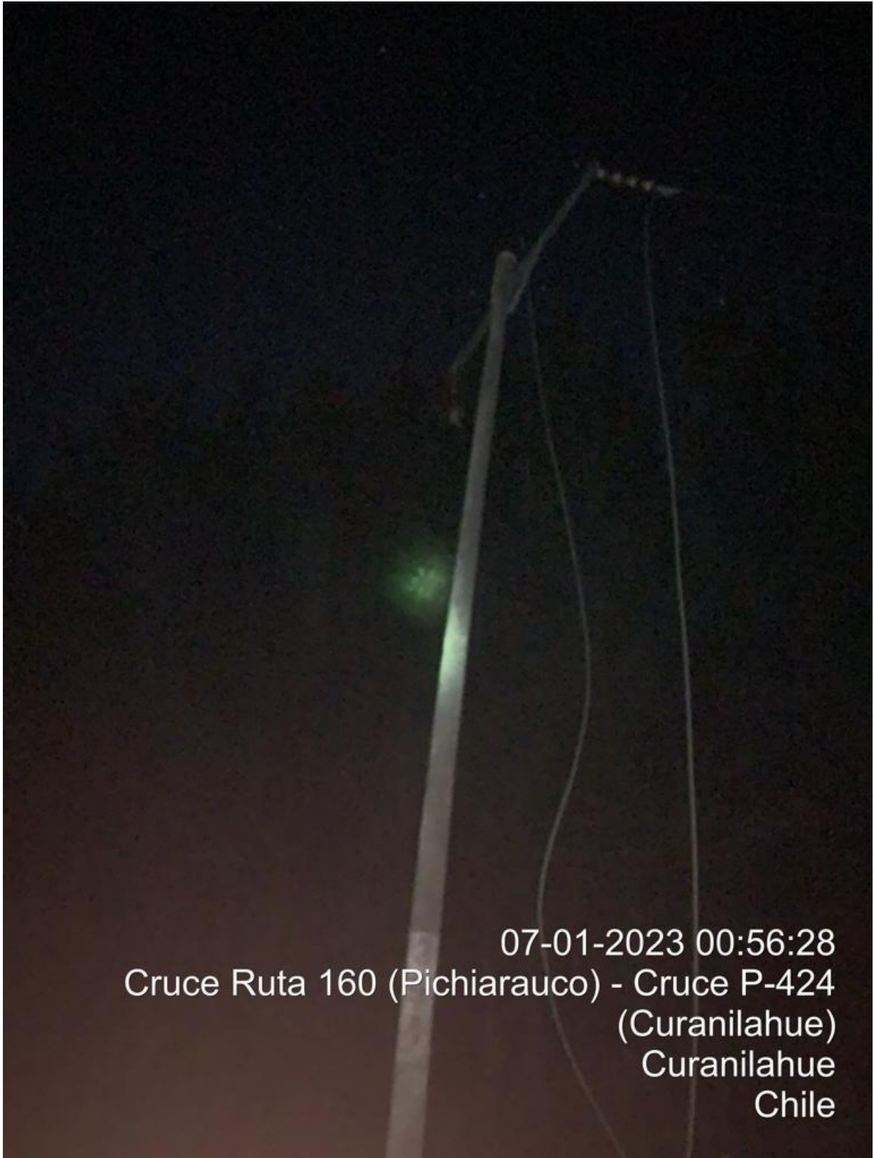
Fotografía N° 1: Daños en estructura 391 de línea LT 66KV Curanilahue-Tres Pinos.
