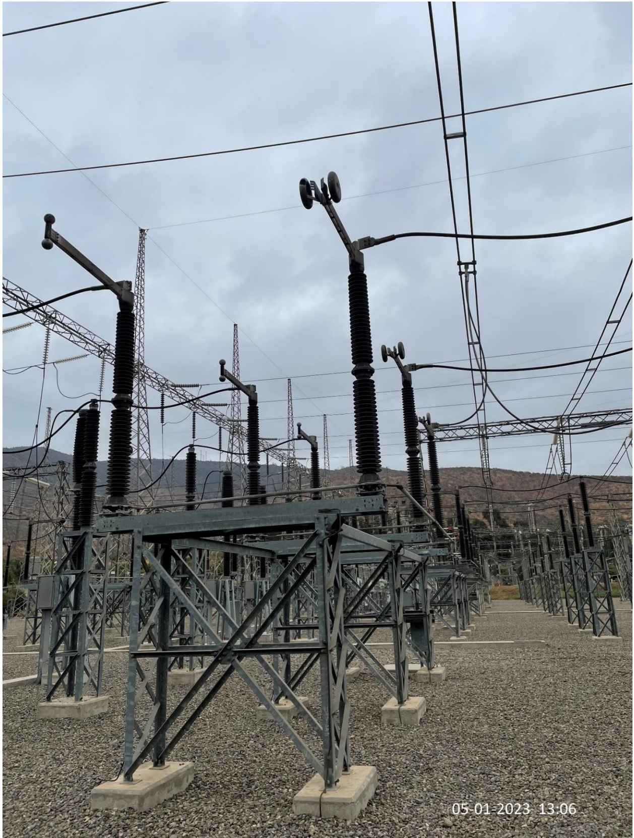
Figura 3: Desconectador 89J8-1 de la S/E Quillota.
