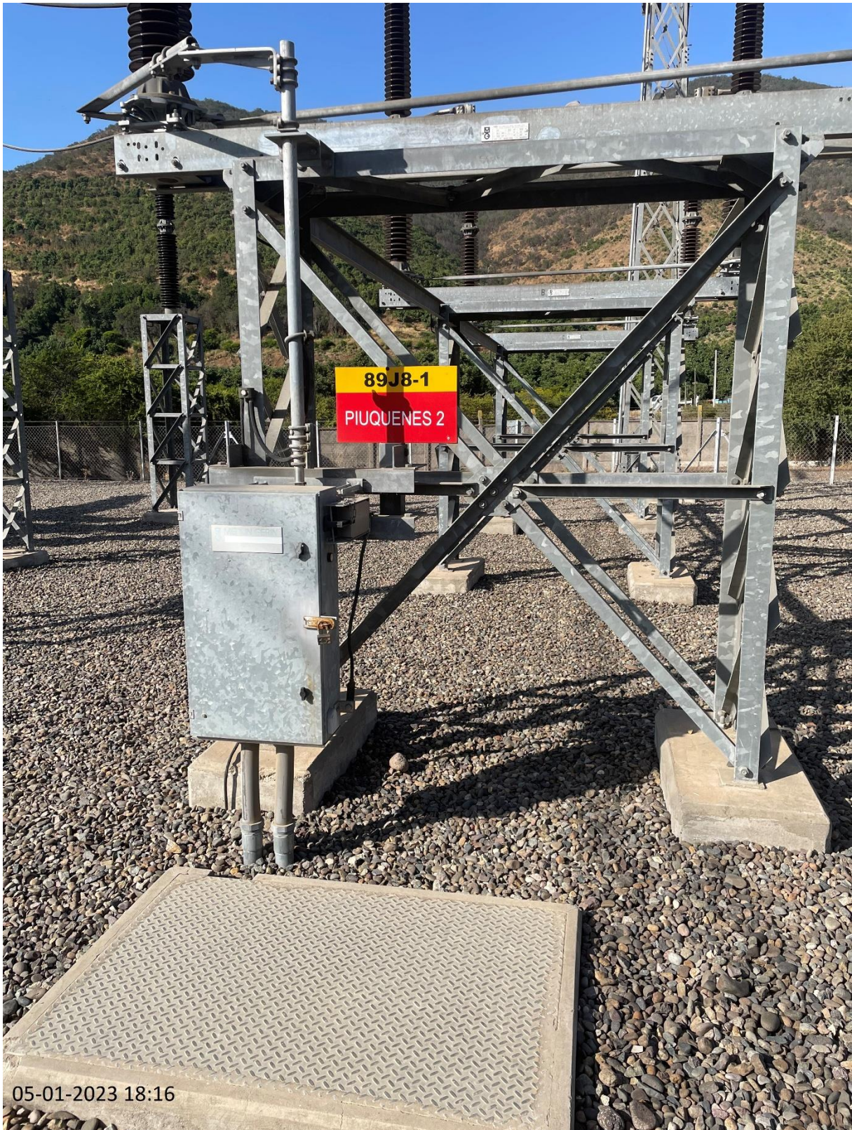
Figura 2: Desconectador 89J8-1 de la S/E Quillota.
