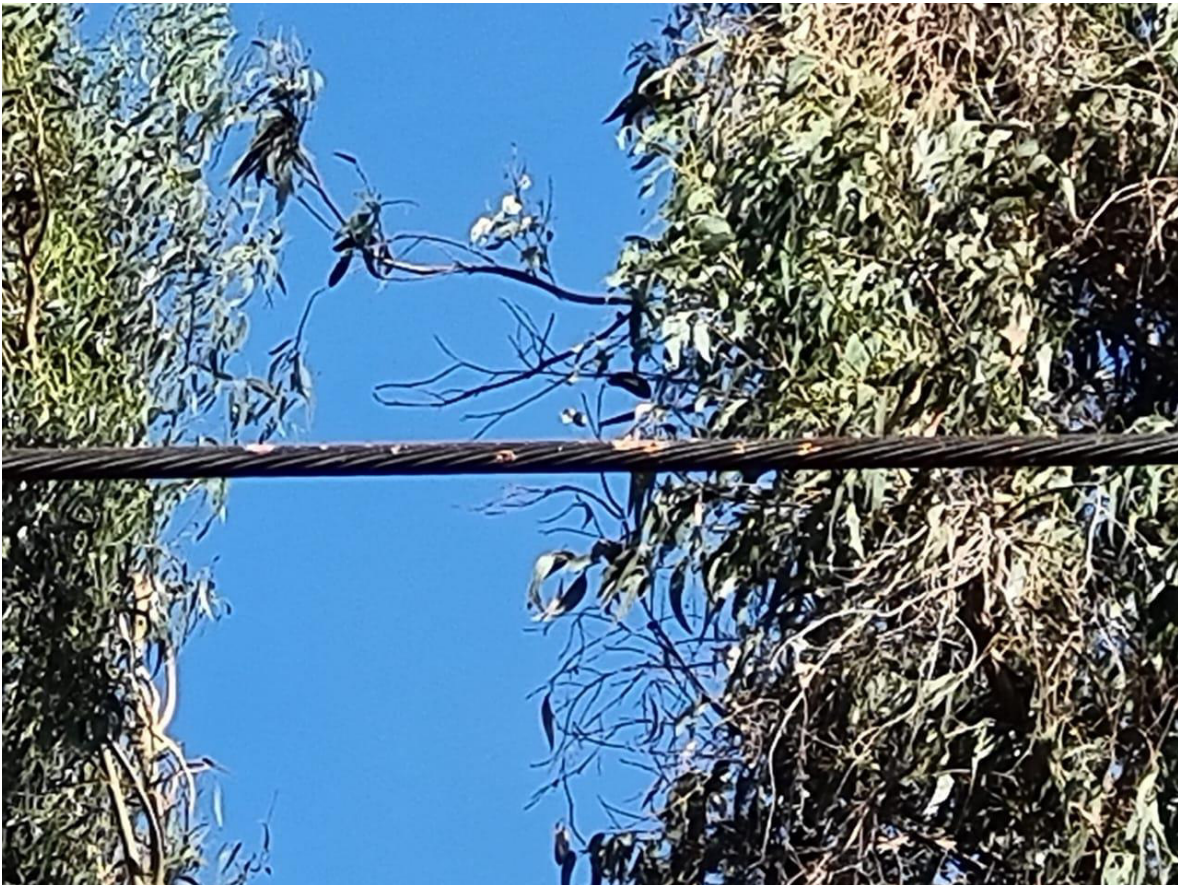
Figura 14. Conductor afectado por el incendio
