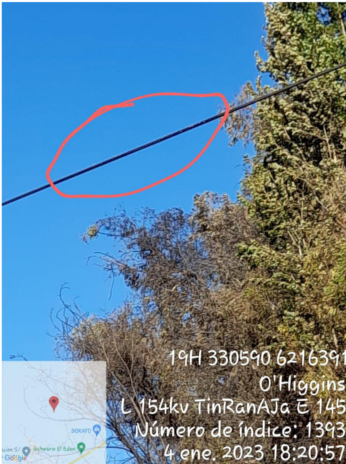
Figura 12. Tramo afectado por el incendio
