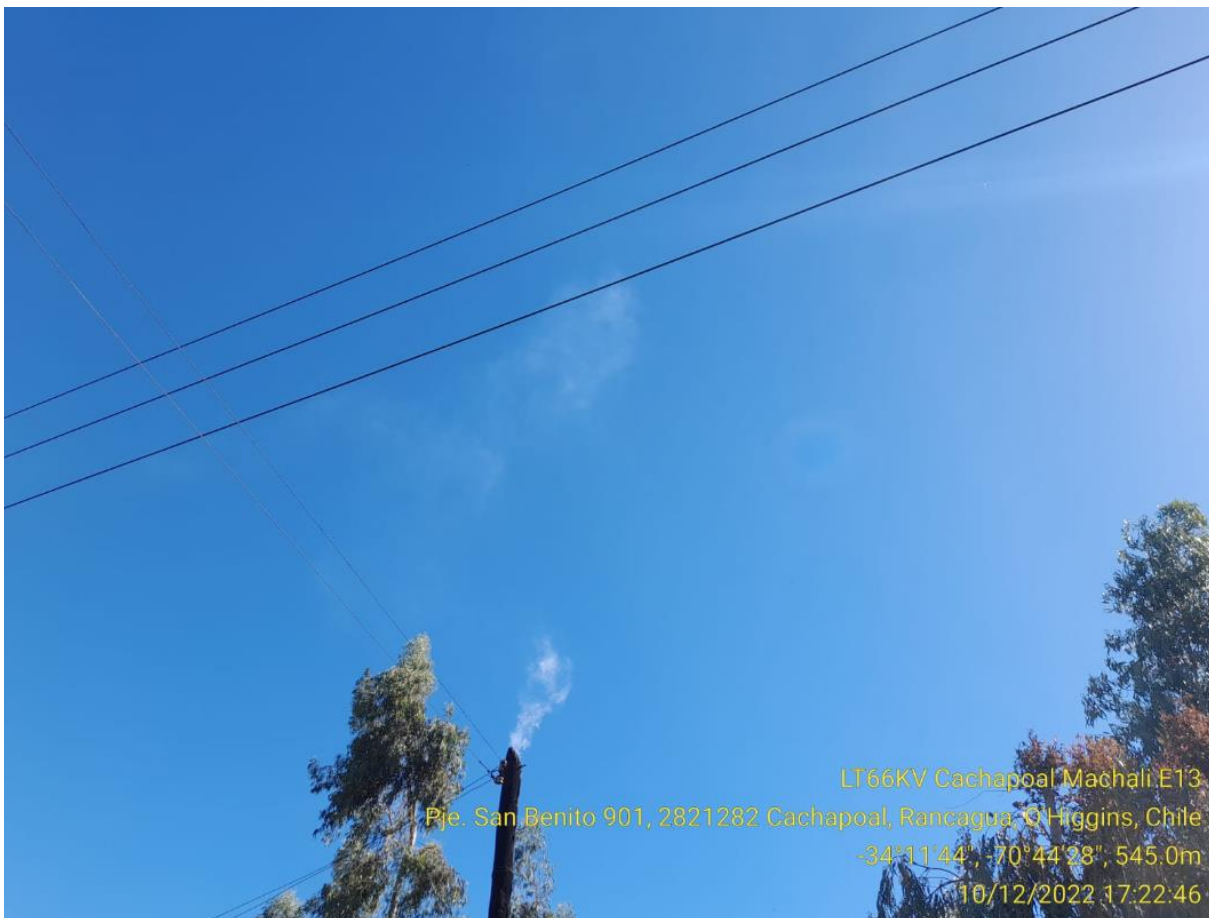
Imagen N°3 , Instalaciones, L66kV Cachapoal – Machalí vano 13 – 14 sin novedades
