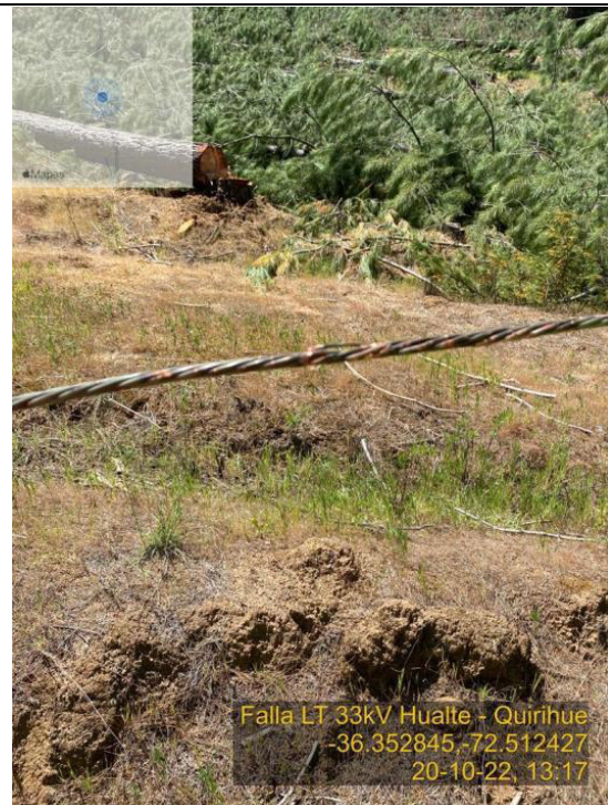
Fig. N°2 Conductor con descarga.
