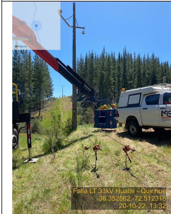
Fig. N°3 Daño en crucetas por caída de árbol
