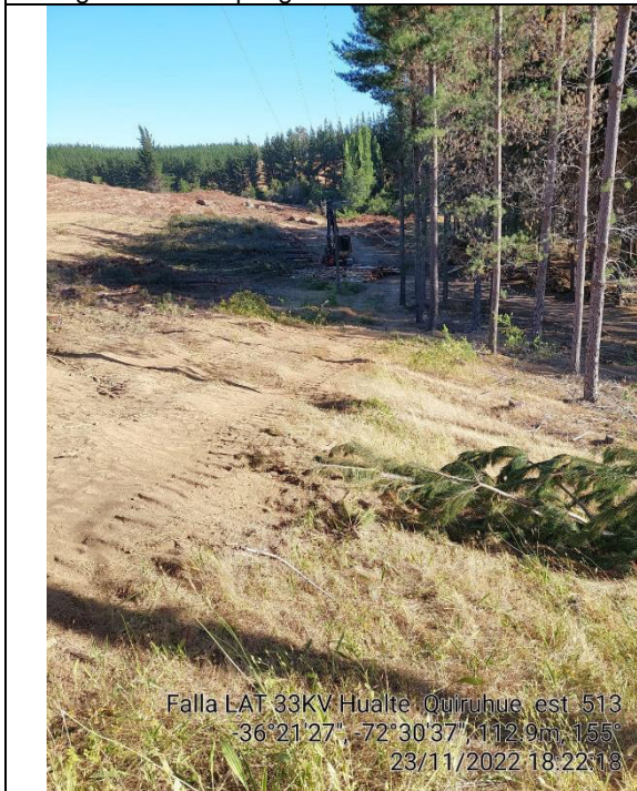
Fig. N°3 Maquinaria trabajando que genera el choque al árbol y posterior caída de este a la línea.
